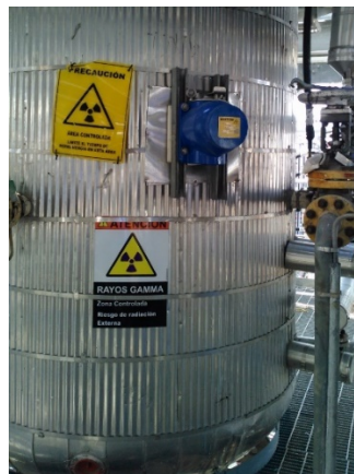
Figura 11. Medidor nuclear. Tanque D16, Planta de alquilación, Refinería de Cartagena S.A.
