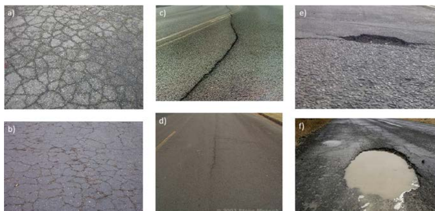
Figura 1. Ejemplos de imágenes en el conjunto de datos: a-b) grieta de cocodrilo, c-d) grieta lineal, e-f) bache
