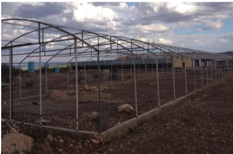
Figura 12 Estructura de invernadero UPZ
