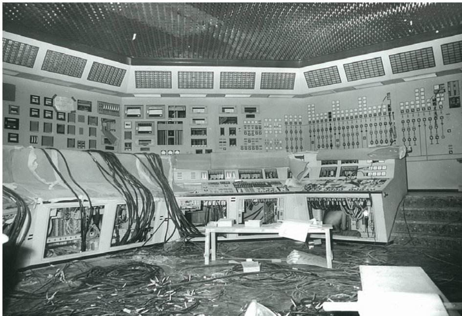
Figura 7. Trabajos de cableado en la Sala de Control. Durante los conflictos se temieron sabotajes en el cableado. Fuente: Archivo ANAV.
