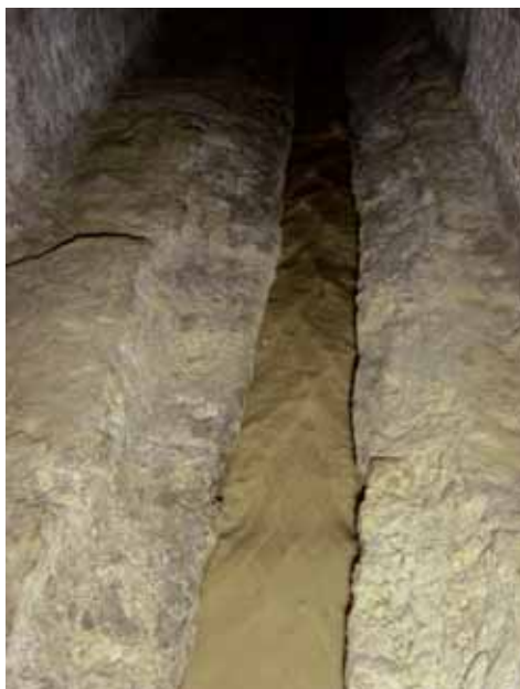
Fig. 17. Canaleta central en funcionamiento (2004).
