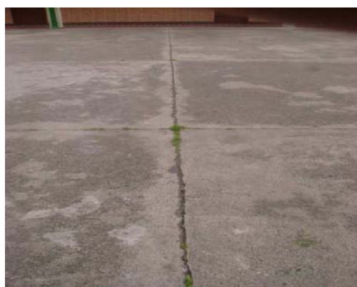
Foto 9: Rastreo de grietas en el piso por medio del bastón (caminar en línea recta)
